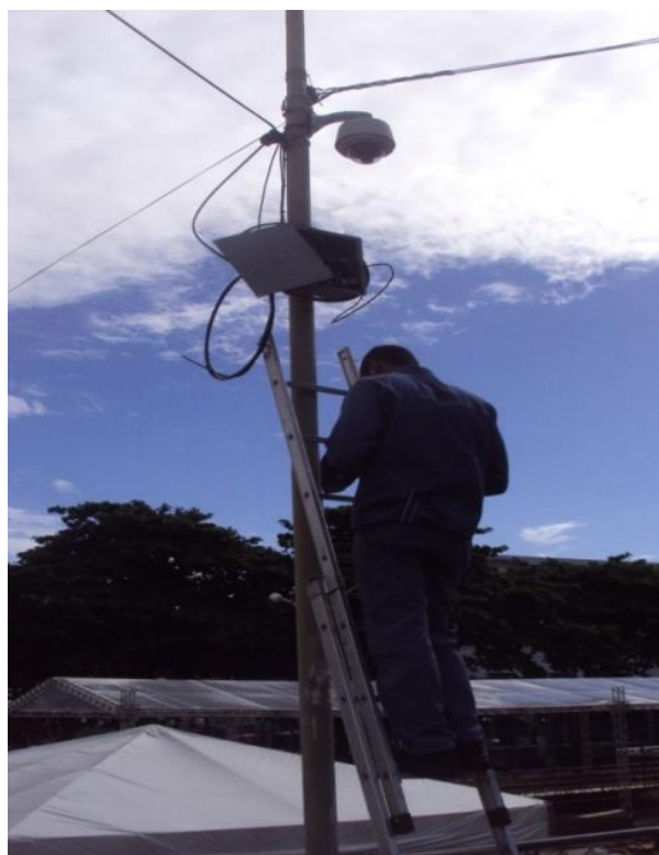
Figura 22: Manutenção técnica de câmera na quadra de esportes de Ondina
