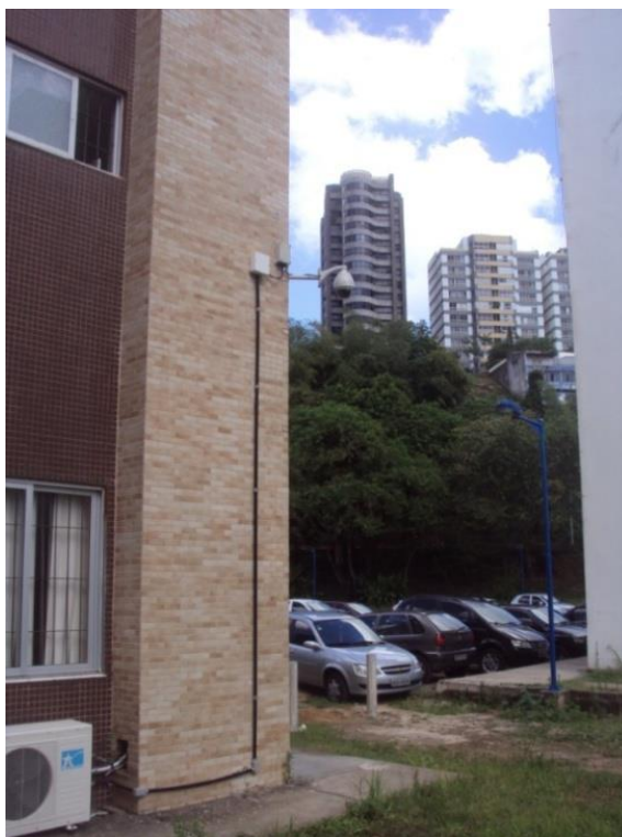
Figura 17: Câmera IP instalada nas adjacências do Paf IV
