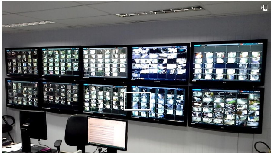
Figura 12: Sala de videomonitoramento
