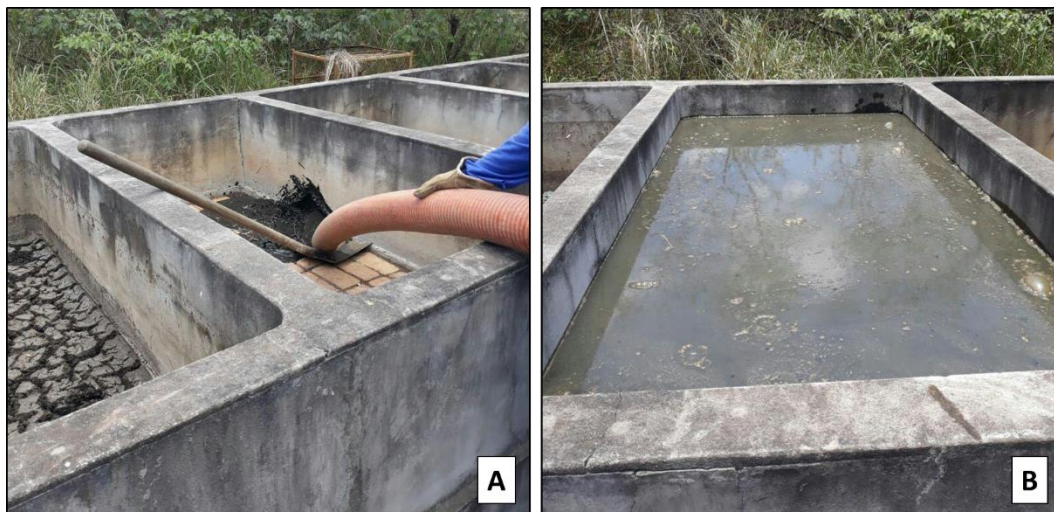
Figura 8 – (A) Imagem lateral do leito de secagem no início da descarga e (B) Imagem frontal do leito de secagem carregado de LE.
