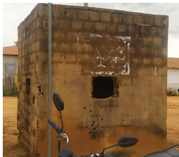
Figura 48 – Espaço para manutenção da água
