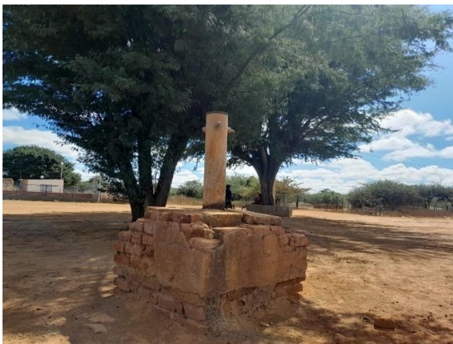
Figura 16 – Chafariz de Abastecimento desativado – Comunidade de Segredo
