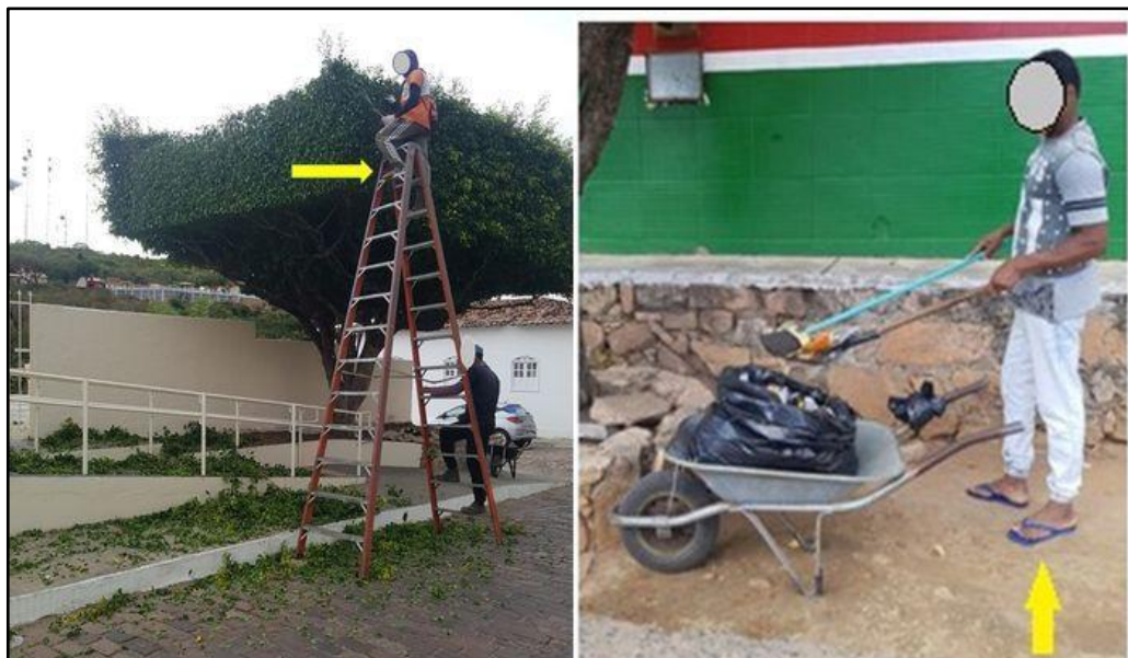
Figura 13 - Funcionários sem equipamentos de proteção individual (EPI'S), Andaraí-Ba, 2023.
