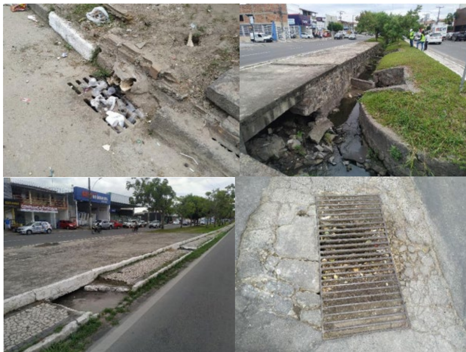
Figura 88 - Infraestrutura deficiente em vários bairros de Feira de Santana, Bahia.
