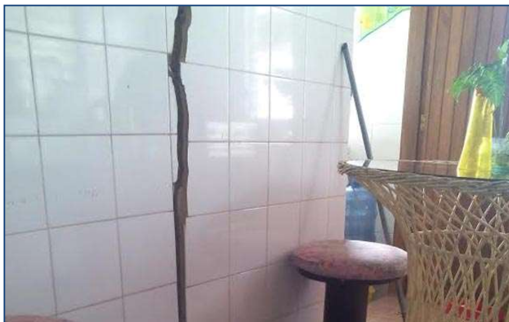
Figura 56: Rachaduras na parede da cozinha de uma casa de campo Alegria, Lagunillas (2016).
