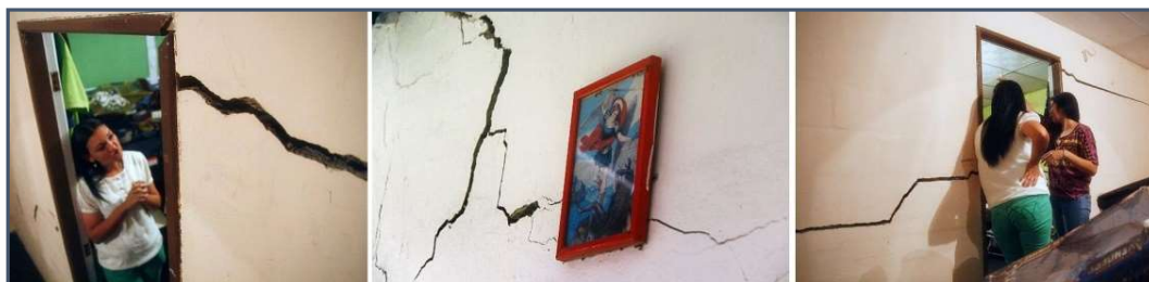
Figura 57: Rachaduras na parede interior de uma casa em Campo Alegría, Lagunillas (2017).
