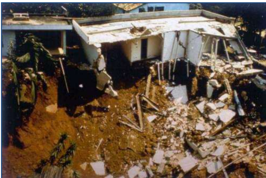
Figura 17: Registro da subsidência em Cajamar (1986).
