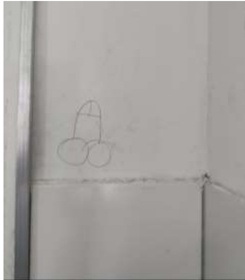
Registro fotográfico 1 - Parede da sala de aula do 9º ano.
