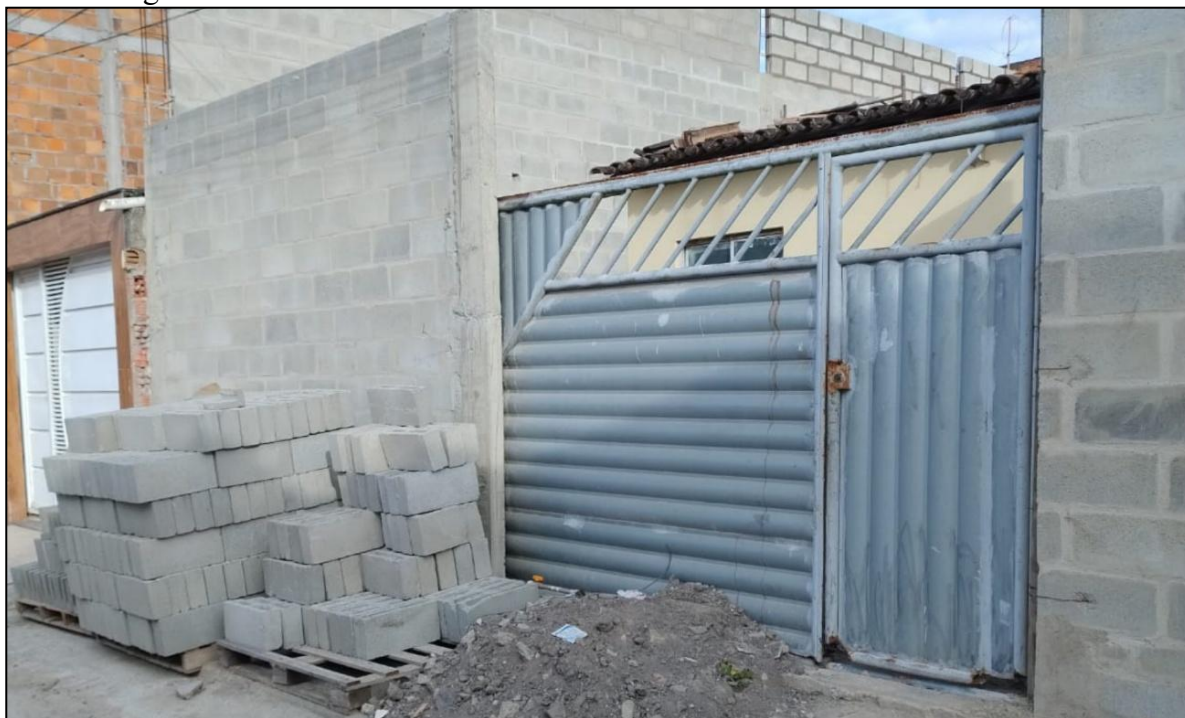
Figura 108 - Passeio intransitável devido ao acúmulo de materiais de obra.
