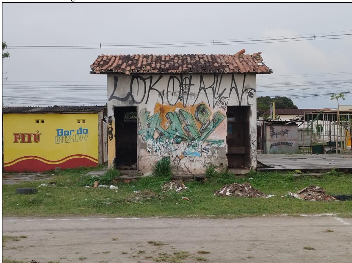
Figura 100 - Estrutura de banheiro abandonado vista frontal
