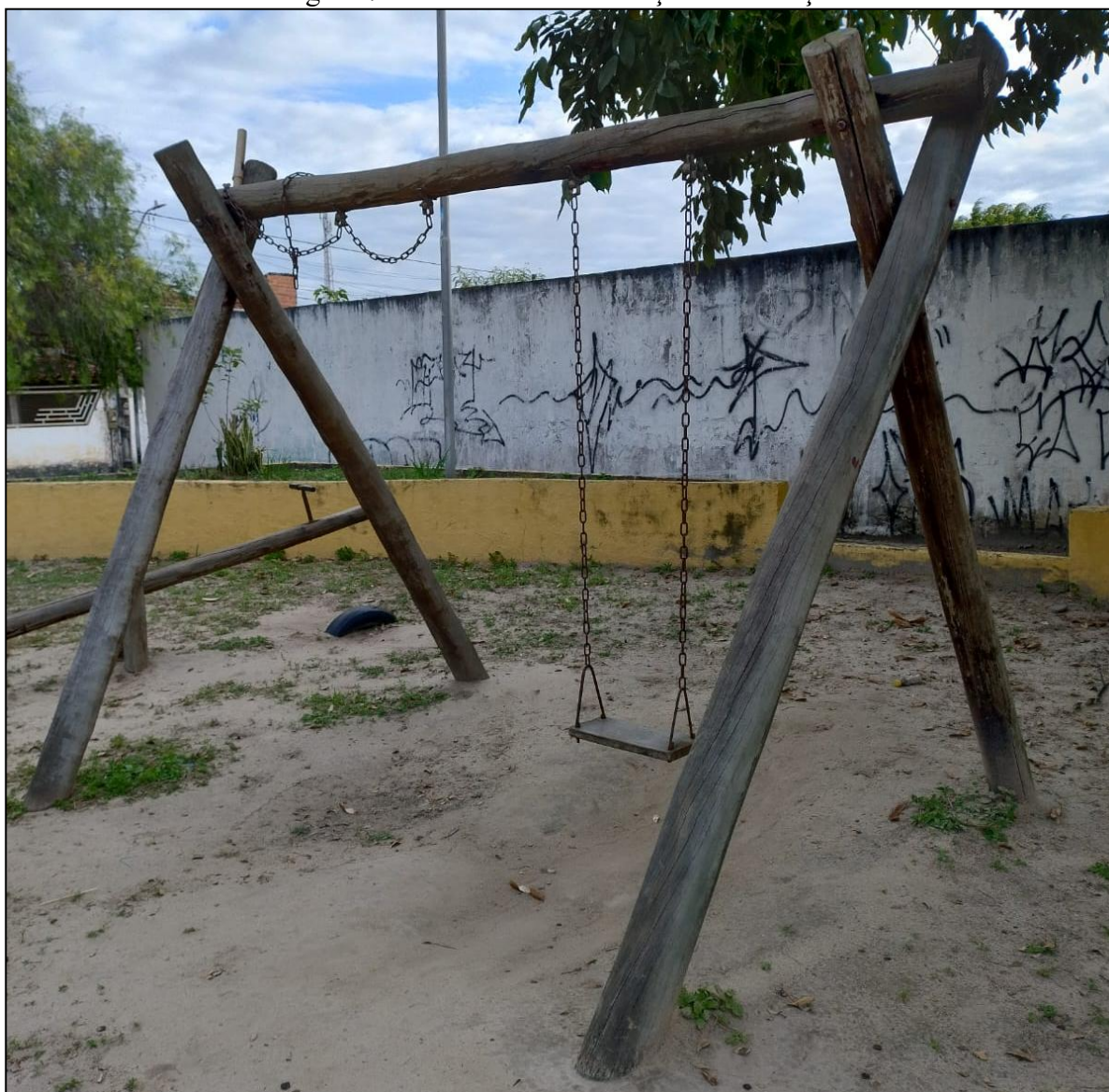
Figura 74 - Estado de conservação de balanço
