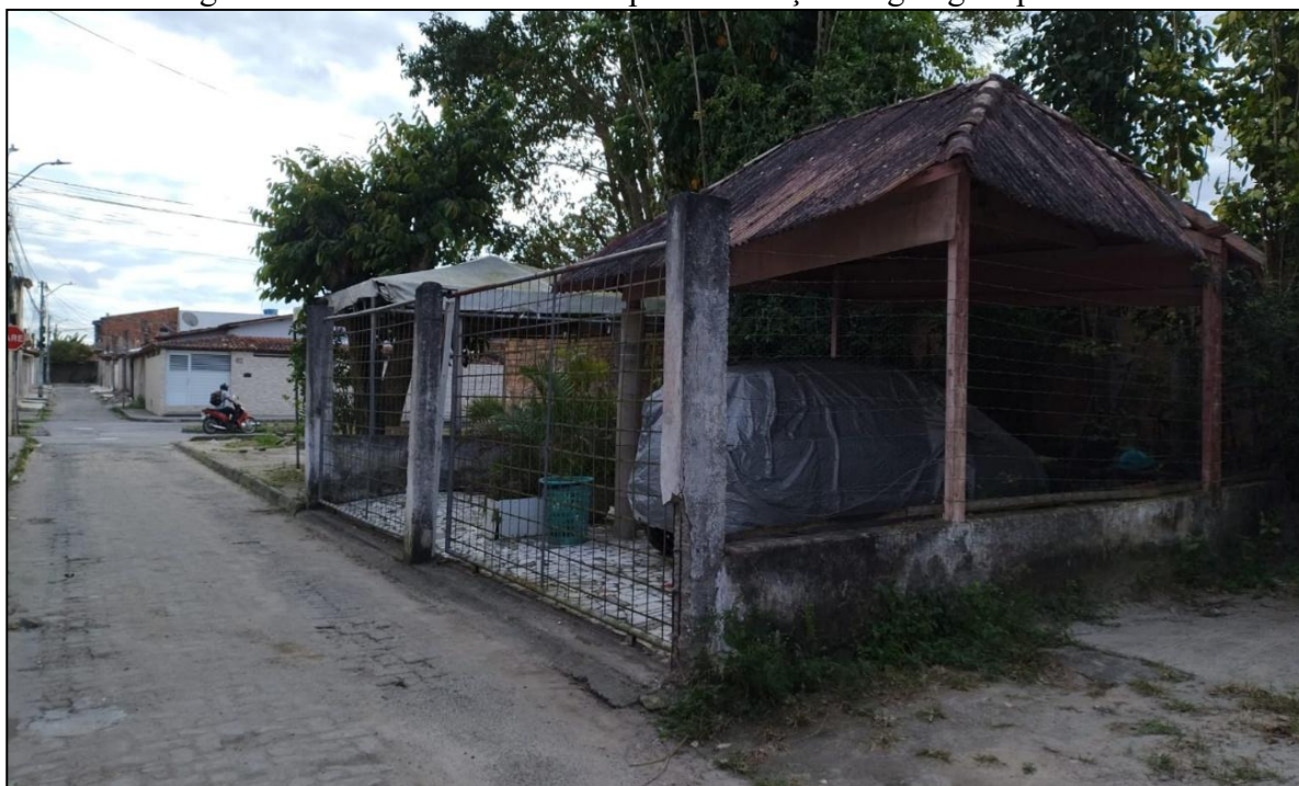
Figura 109 - Passeio sacrificado por construção de garagem privada.
