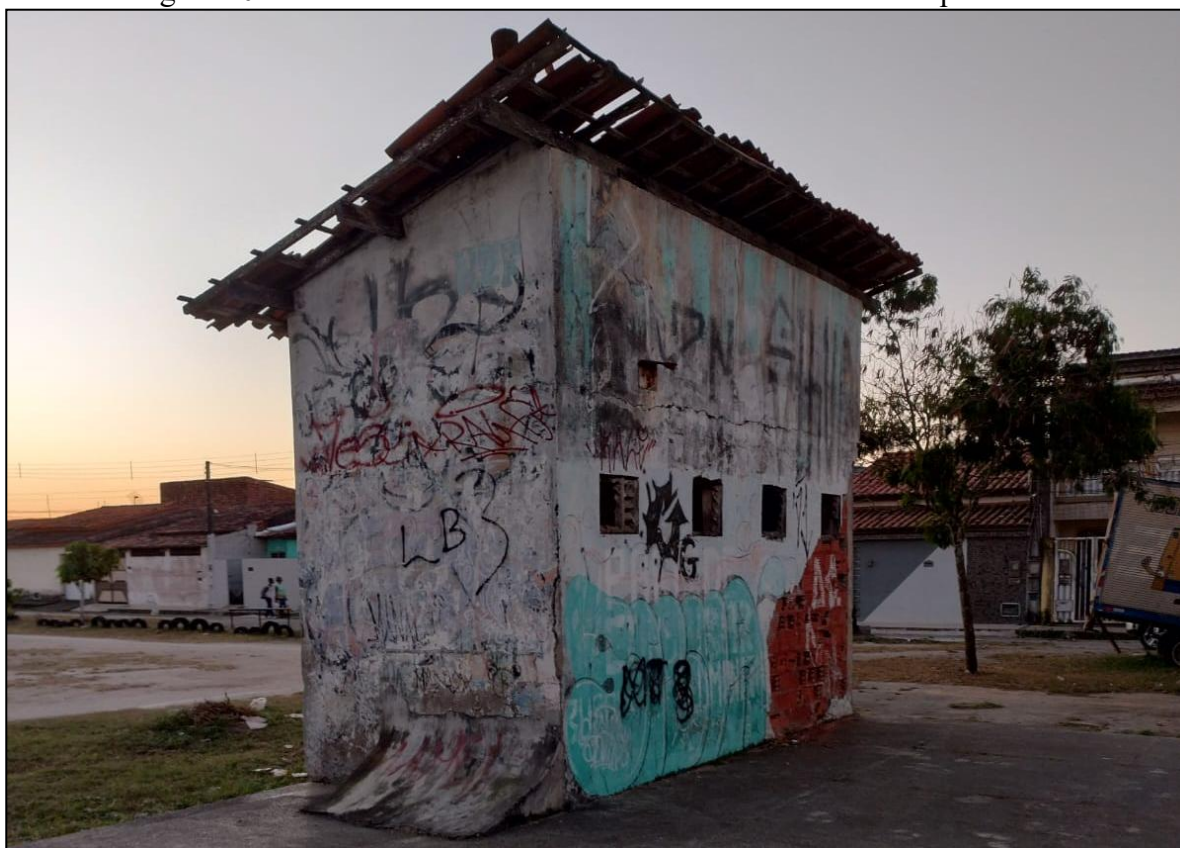
Figura 101 - Estrutura de banheiros abandonados vista de lado posterior
