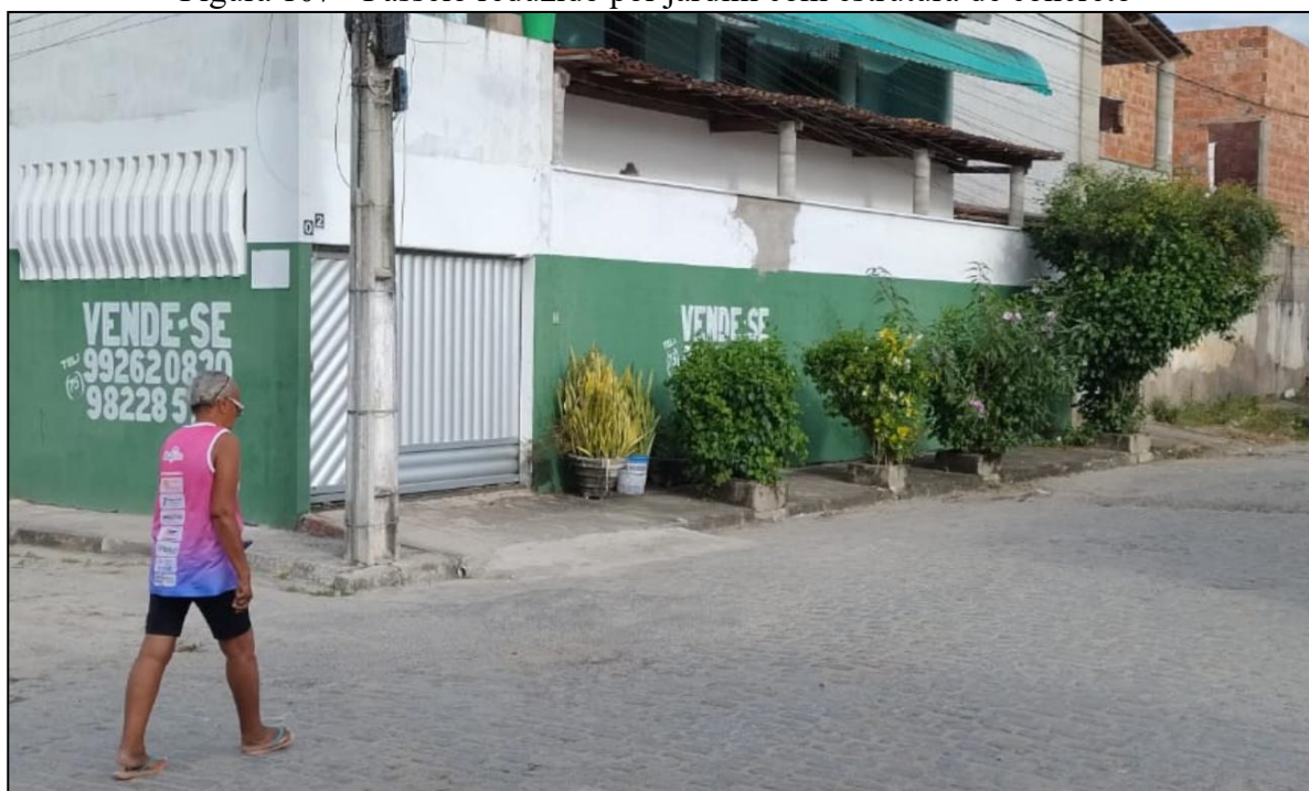
Figura 107 - Passeio reduzido por jardim com estrutura de concreto
