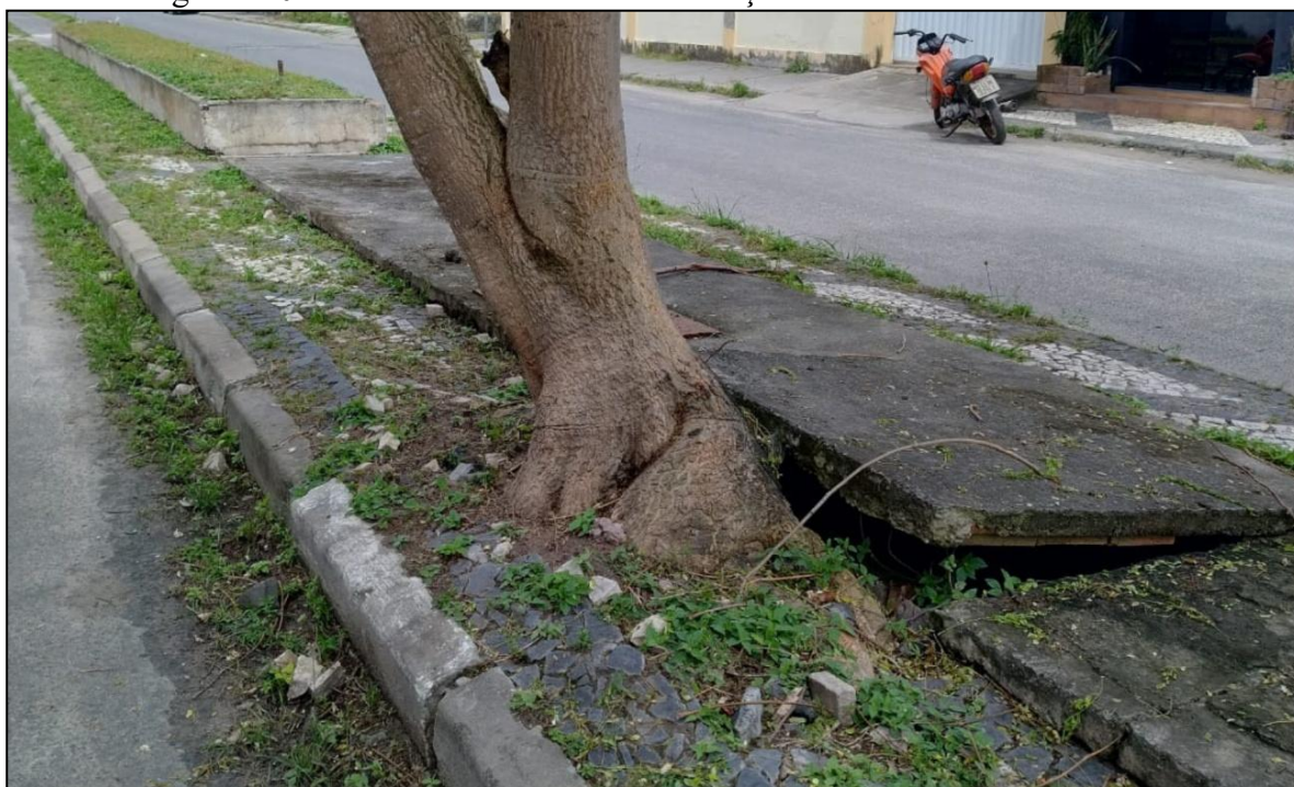
Figura 110 - Raízes de árvore elevam a calçada criando desnivelamento.
