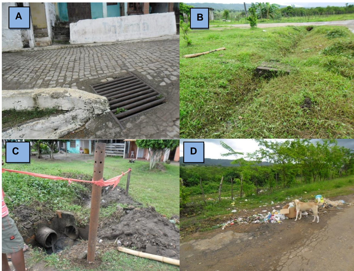
FIGURA 20 - A- Rede de esgoto para captação de água pluvial; B- Rede de esgoto a céu aberto; C- Rede de esgoto que segue para despejo em área de manguezal; D- Lixo espalhado em via pública. FONTE: A autora (2013)
