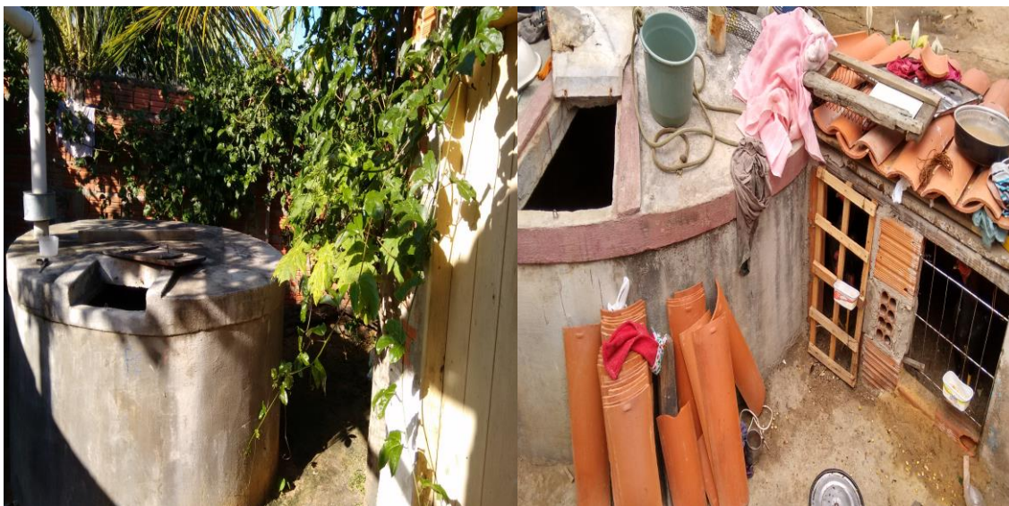
Figura 17 - A presença de árvores próximas e poleiro dividindo parede com a cisterna
