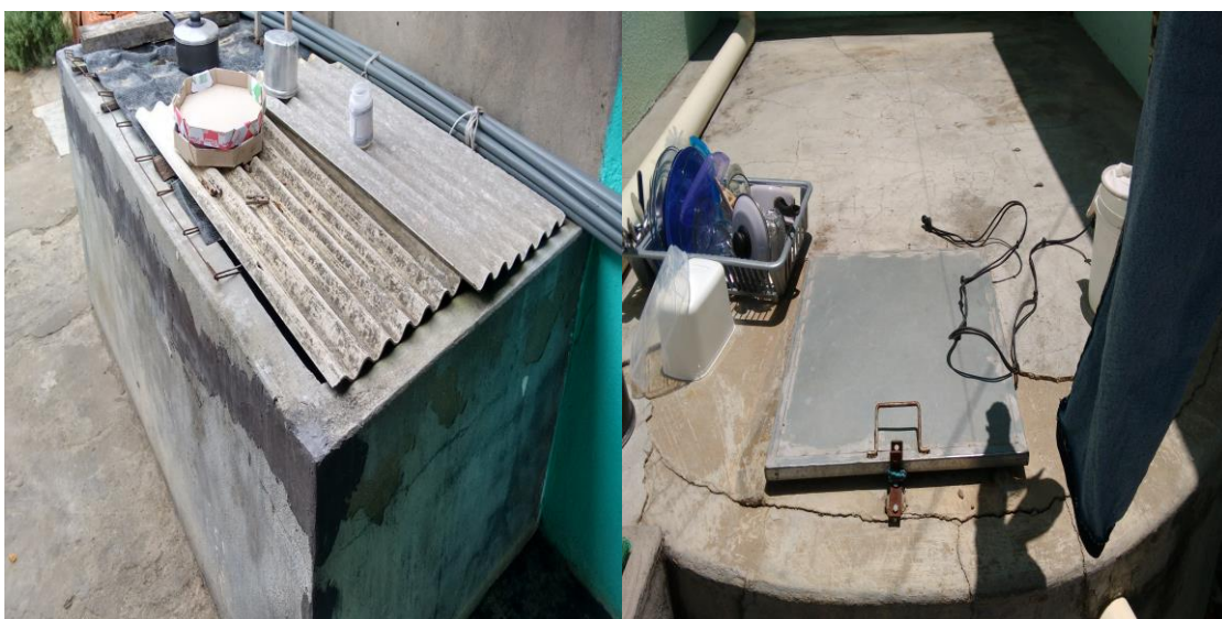
Figura 16 - A vedação da cisterna sendo que a 1 a encontra-se aberta e 2 a fechada
