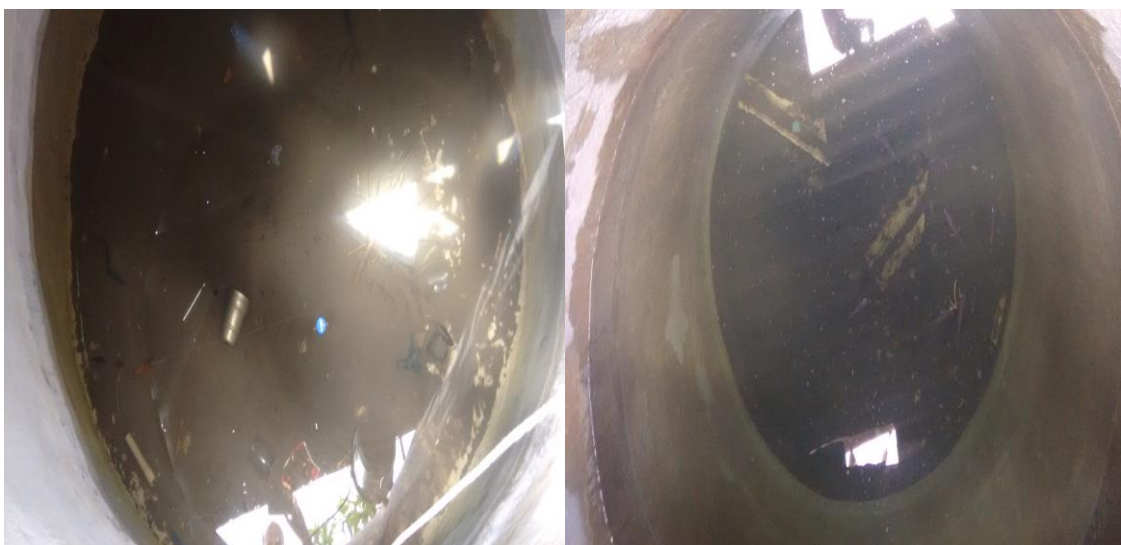
Figura 18 - A presença de depósito de matéria orgânica no fundo da cisterna
