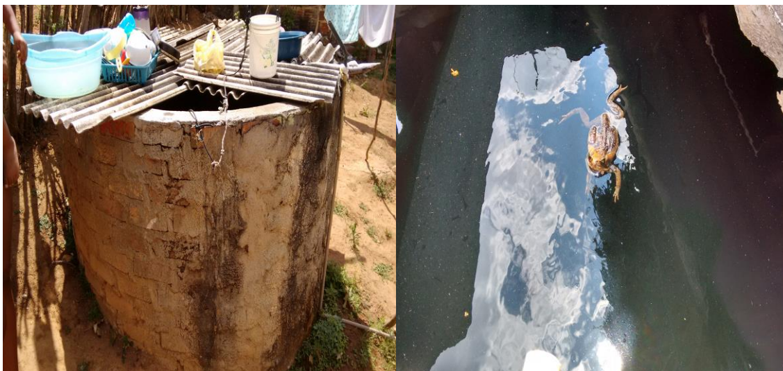
Figura 25 - Situação da vedação dos tanques e presença de anfíbios dentro do reservatório em Baixa Grande
