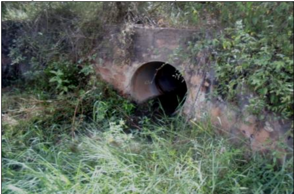
Figuras 64 – Lançamento de efluentes domésticos no açude do Gravatá – Serrinha - Bahia
