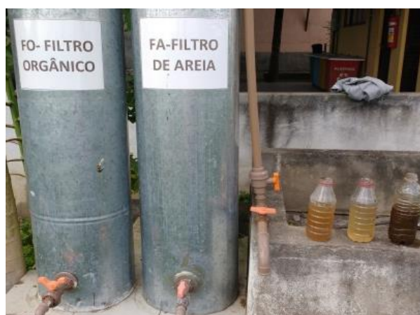
Figura 7 - Filtros orgânico e de areia utilizados no tratamento dos efluentes
